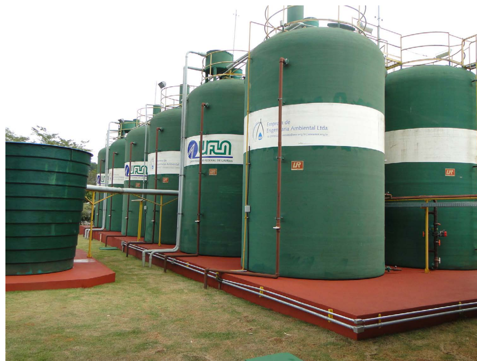
Figura 112: Estação de Tratamento de Esgoto.
